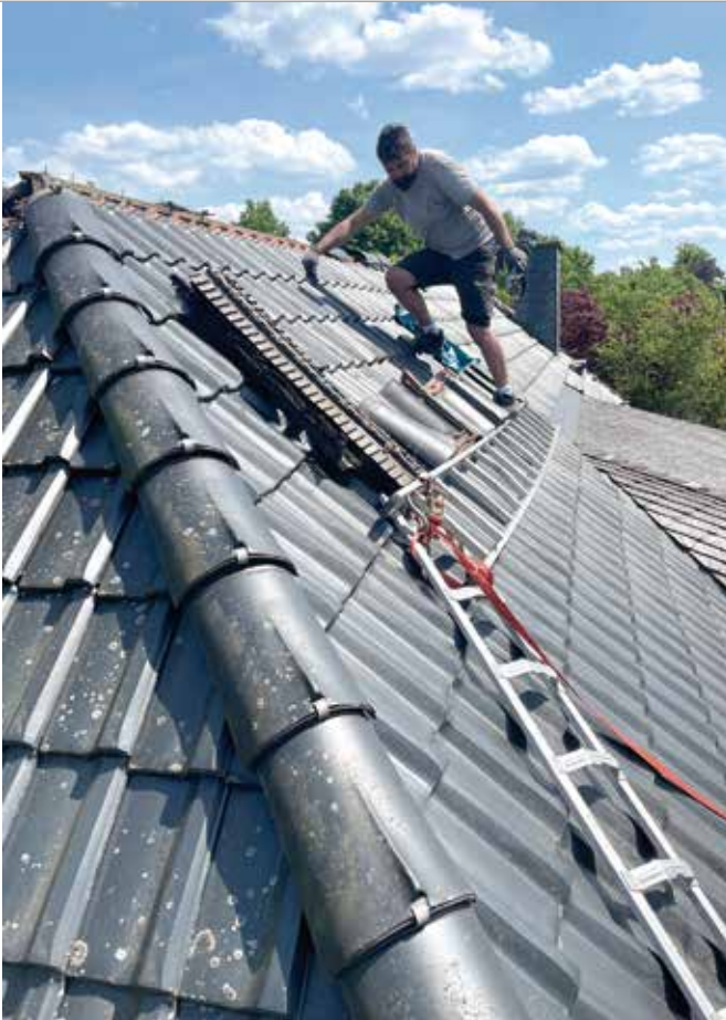
Klassische Dacheindeckung auf dem Steildach: SWG Dach & Wand GmbH ist ein Allrounder.
