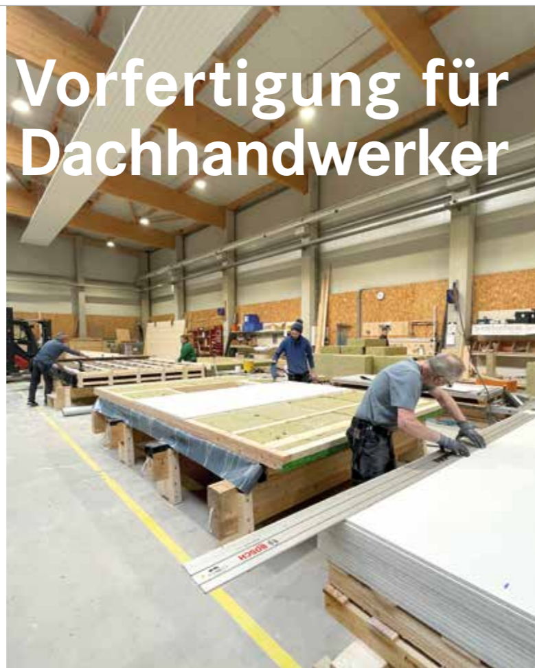
In der Vorfertigung gibt es eine 28 Meter lange Tischanlage zur Montage mit zwei Deckenkränen.
