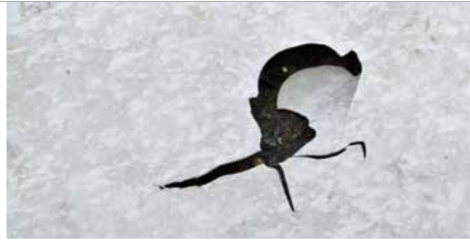
Glatt durchschlagen haben hier die 40 Millimeter dicken Hagelkörner die Kunststofffolien.
