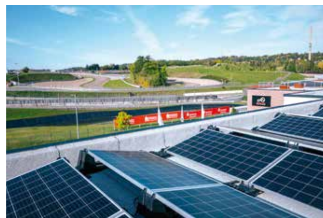
Auch auf dem eigenen Firmensitz direkt am Sachsenring wurde eine PV-Anlage installiert.
